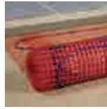
Chauffage par le sol
