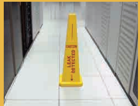
Faux-planchers des salles informatiques
