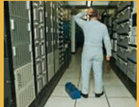
Salles de serveurs et centres de communications
